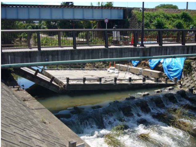
崩落した橋梁（竜泉寺川、蓑川新町）
